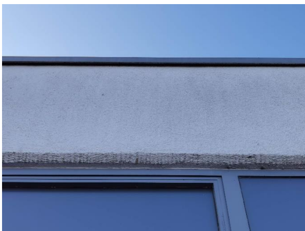
Abb. 18: Spalten an Dachverkleidung von der Sulzbacher Straße 170
