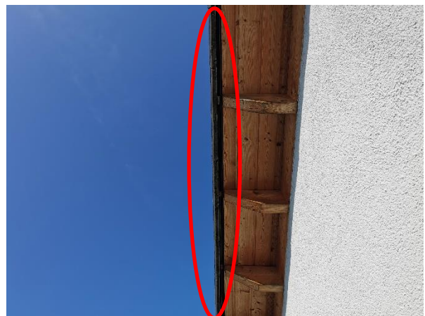
Abb. 10: Spalten in Holzverkleidung an Garage
