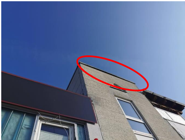
Abb. 16: Spalten in südlichen Attikaverkleidung in Sulzbacher Straße 176
