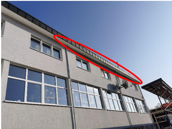
Abb. 11: Leichte Schäden an der Attikaverkleidung am Gebäude der Sulzbacher Straße 180
