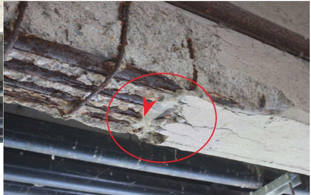
Zustand 27.09.2024: Ausbruch erweitert. Risse ziehen sich Richtung Mitte
