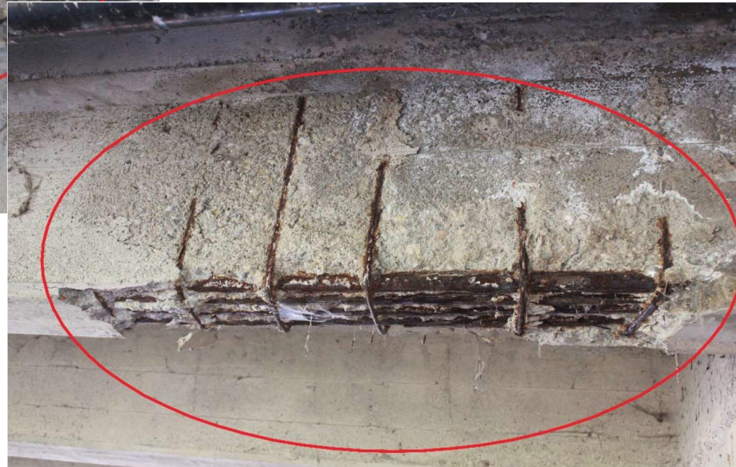
Zustand des Trägers 22.05.2025
