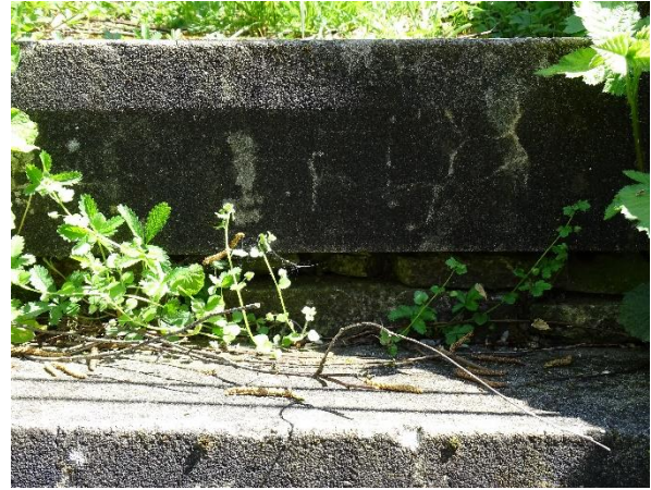
Abb. 22: Spalten unter bewachsenen Treppenstufen
