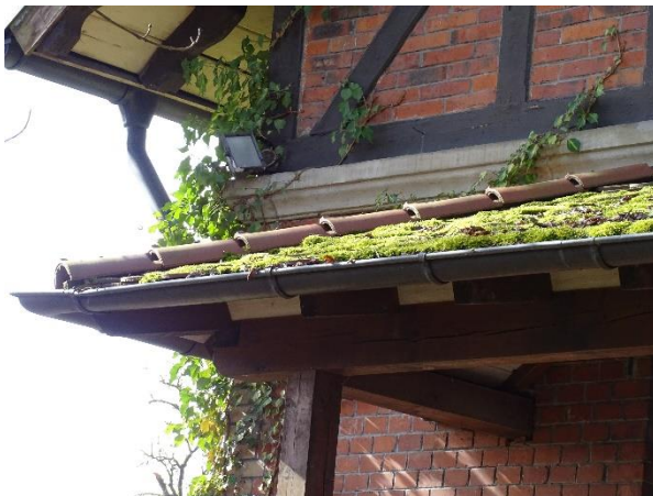
Abb. 19: Dachziegelspalten am Vordach über der Eingangstür an der Nordseite des Gebäudes
