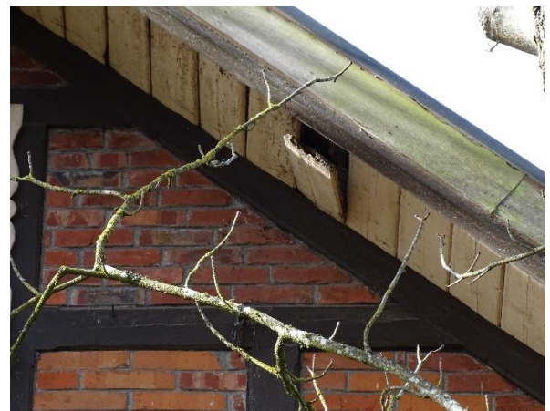
Abb. 14: Spaltöffnung im Traufbereich des Gebäudes
