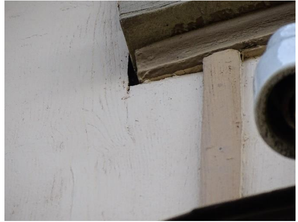
Abb. 18: Spalt am Fensterbrett des Dachgeschossfensters an der Südwestseite des Gebäudes
