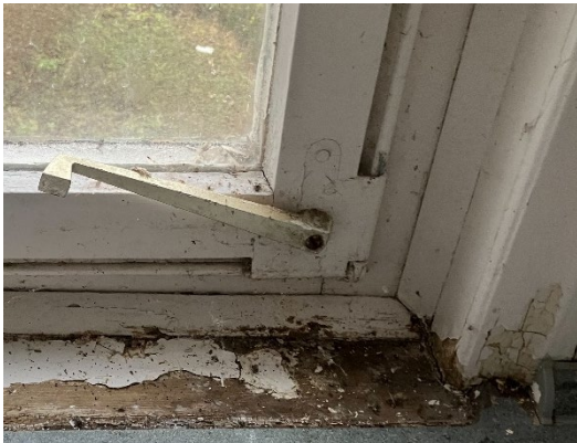
Fenster instand setzen; Wo sinnvoll Fenster tauschen
