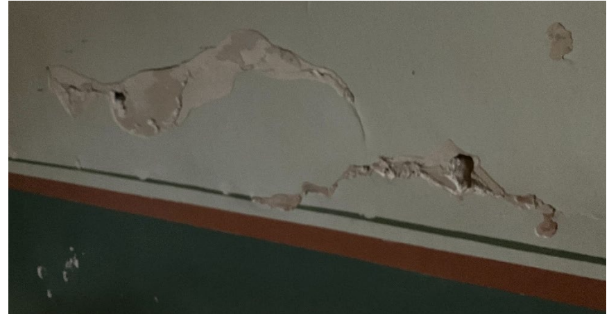
Schadhafter Wandputz im Eingangsbereich
