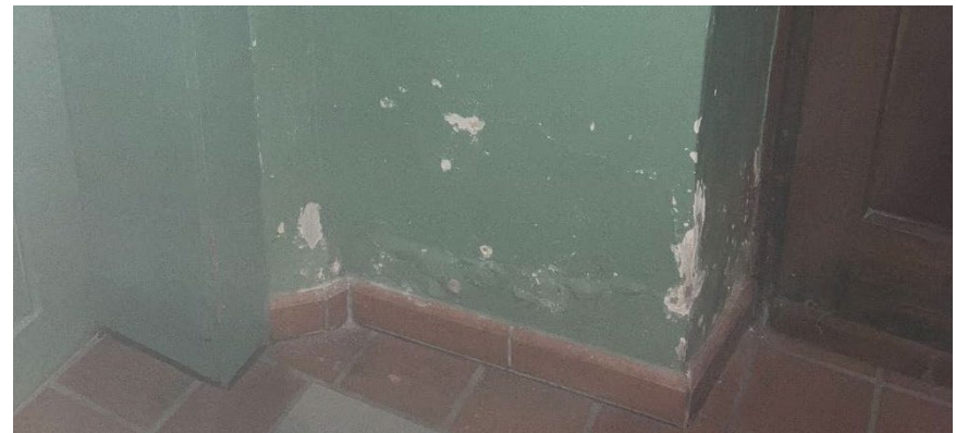
Schadhafter Sockelputz im Eingangsbereich
