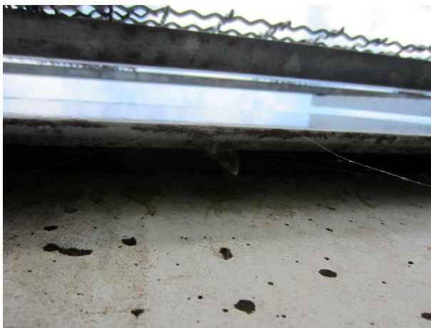
Abb. 16: Blick unter die Verkleidung der Attika der Karl-Euerle-Halle
